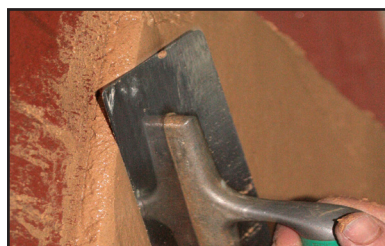
Etape 2 - application à la spatule inox ou à la machine à projeter, sur 1cm d'épaisseur.
